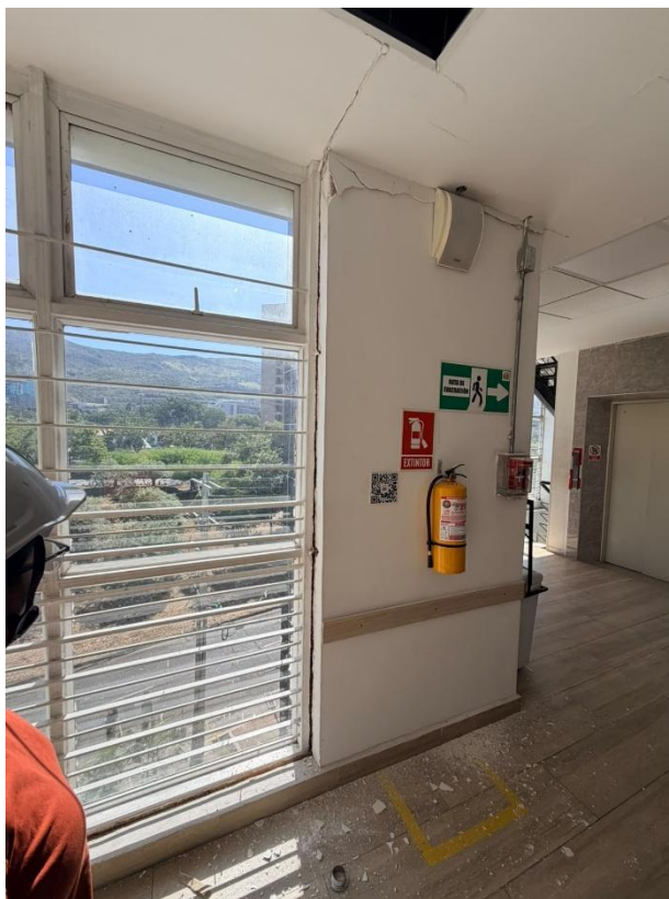
Ilustración 47. Desprendimiento de marcos arquitectónicos
