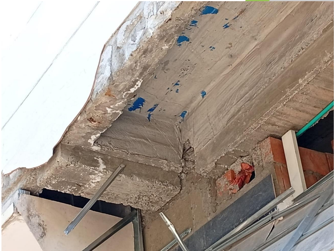
Ilustración 7. Vigas del primer piso expuestas debido a desprendimiento de cielo raso
