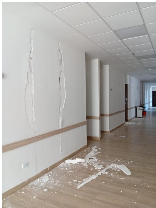
Ilustración 11. Columna 2do Piso en interacción con elementos no estructurales (divisiones en mampostería)
