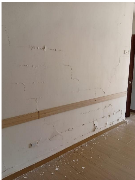
Ilustración 40. Falla de muro en mampostería
