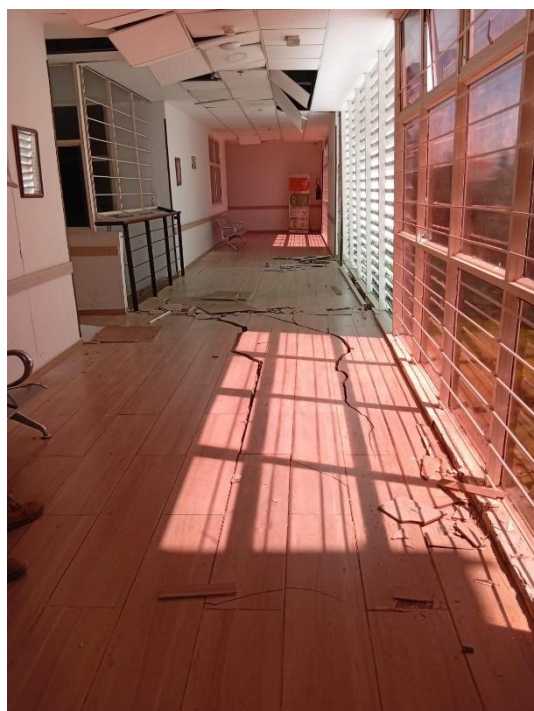
Ilustración 48. Desprendimiento estructura metálica arquitectónica piso 5 frente a fachada AV 4N - INTENALCO - 10-08-2026
