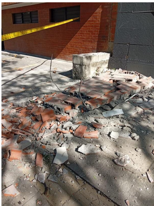
Ilustración 36. Mampostería volcada - INTENALCO -10-08-2026
