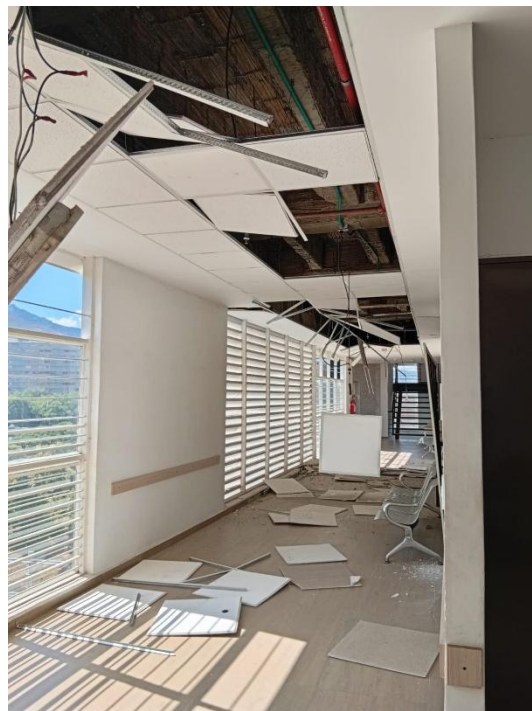
Ilustración 20. Desprendimiento de cielo raso de placa de entrepiso
